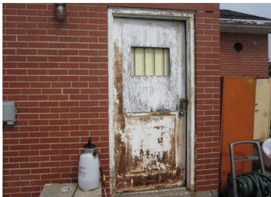
Rusting metal door
