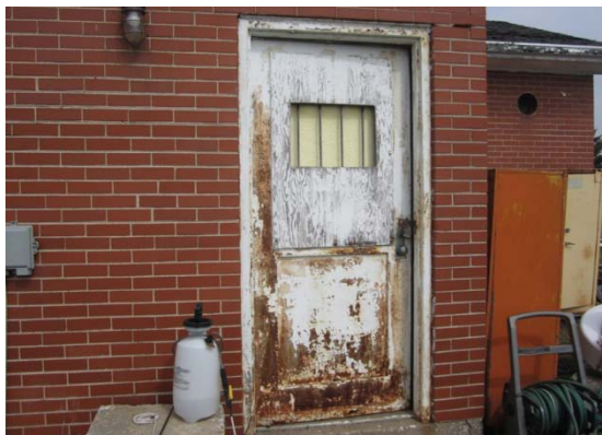
Rusting metal door
