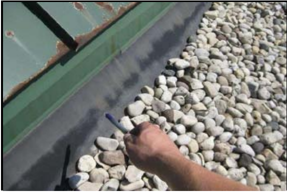
Tented edge flashings
