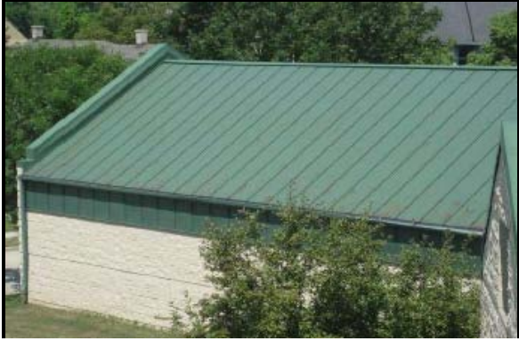
Tented edge flashings
