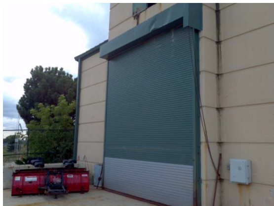
Salt dome garage door – note rust/damage
