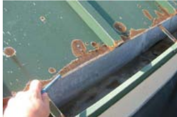
Rusted roof edge
