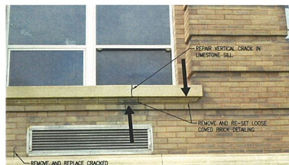
5 LIMESTONE SILL CRACKING, TYP. SCALE: N.T.S.
