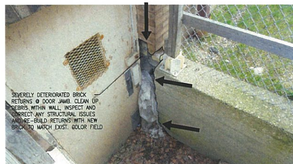
13 DOOR JAMBS DETERIORATED SCALE: N.T.S.
