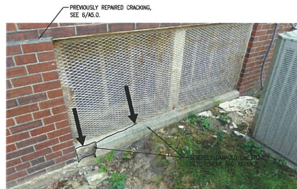
1 DETERIORATED LIMESTONE SILL SCALE: N.T.S.
