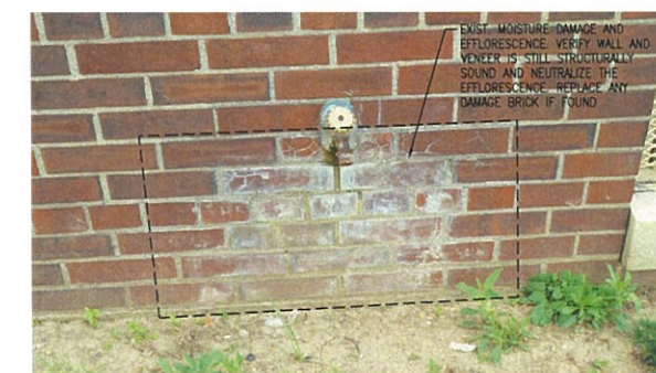
12 BRICK EFFLORESCENCE / WATER DAMAGE SCALE: N.T.S.
