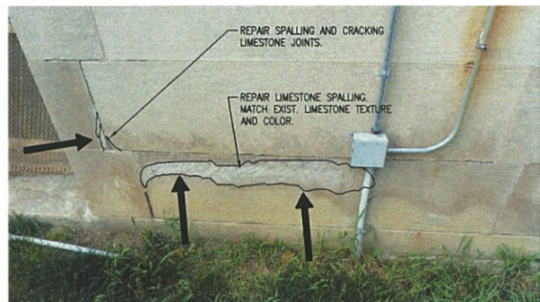
5 SPALLING AND CRACKING AT LIMESTONE SCALE: N.T.S.
