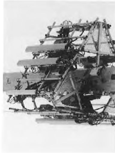
2 PHOTO OF ANTENNA LEVEL SCALE: N.T.S.
